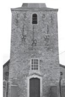
Les réparations des dégâts causés par ce séisme à l'église de Marilles reste visible. Reparaties van de schade aan de kerktoren van Marilles is nog steeds te zien. Repairs to the earthquake damage to the Marilles church are still visible.
