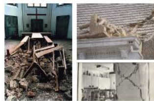
Dégâts à l'église Minderbroederskerk à Roermond (NL) Schade aan de Minderbroederskerk te Roermond (NL) Damage to the Minderbroederskerk church in Roermond (NL)
