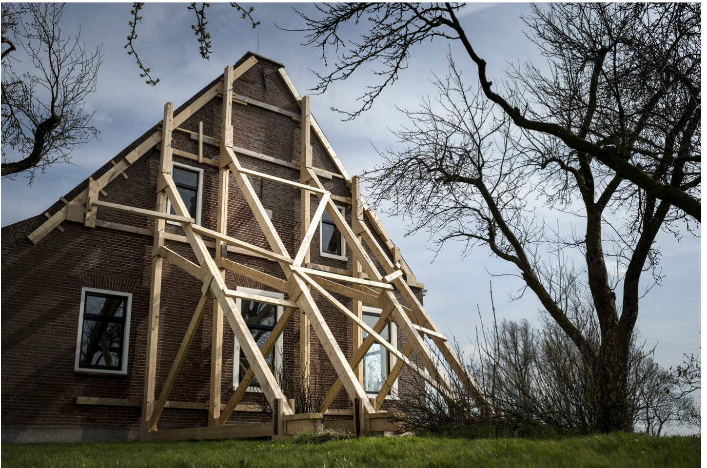
Veel gebouwen in Groningen hebben schade door aardbevingen en verzakkingen ten gevolge van de gaswinning. © Kees van de Veen
